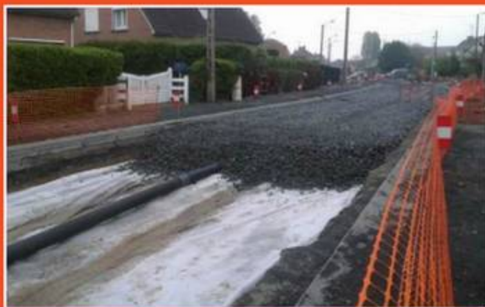
Mise en œuvre d'une chaussée réservoir dans le cadre d'une réhabilitation de voirie - CUINCY (59)
